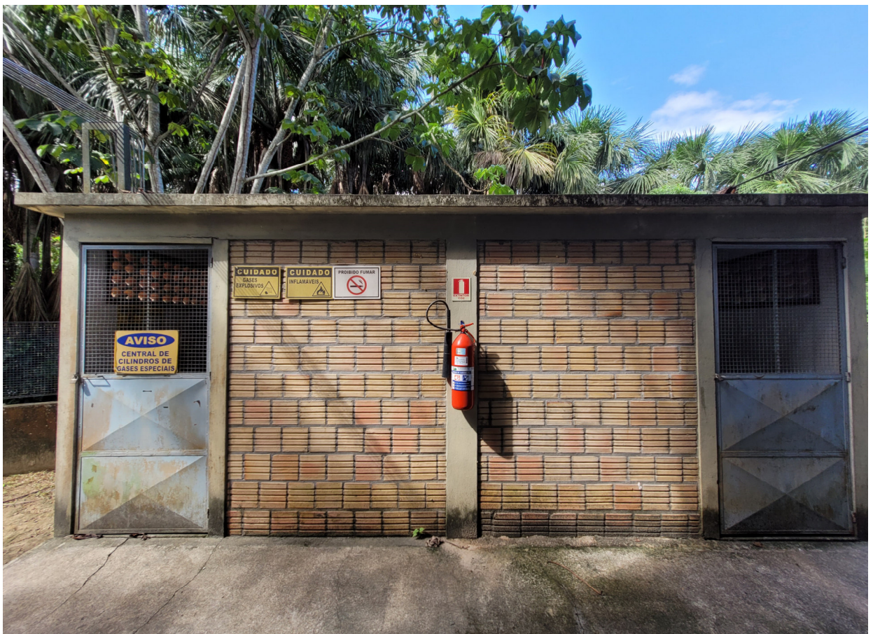
Figura 5 – Central de abastecimento de gases do CLAB.
