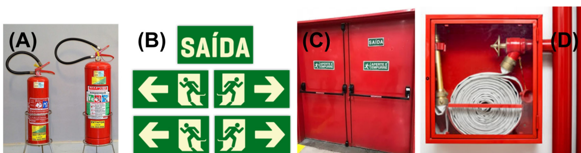
Figura 3 - Infraestrutura do Sistema de Combate a Incêndio do CLAB.
